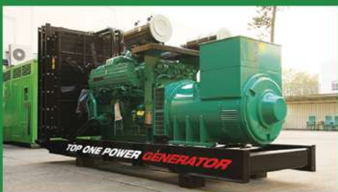
全新開放式發電機組 1100kVA Brand: International Cummins Model: QST30-G4
