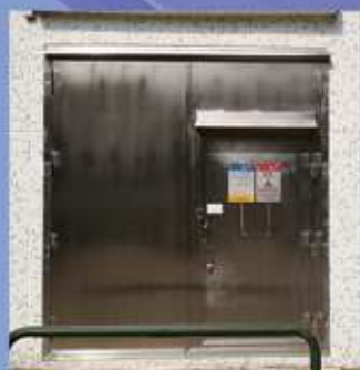
▲ 中電標準不銹鋼火牛房門 CLP Stainless Steel Doors
